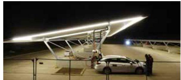
▲ Ladestation eines photovoltaischen Kraftwerks.
